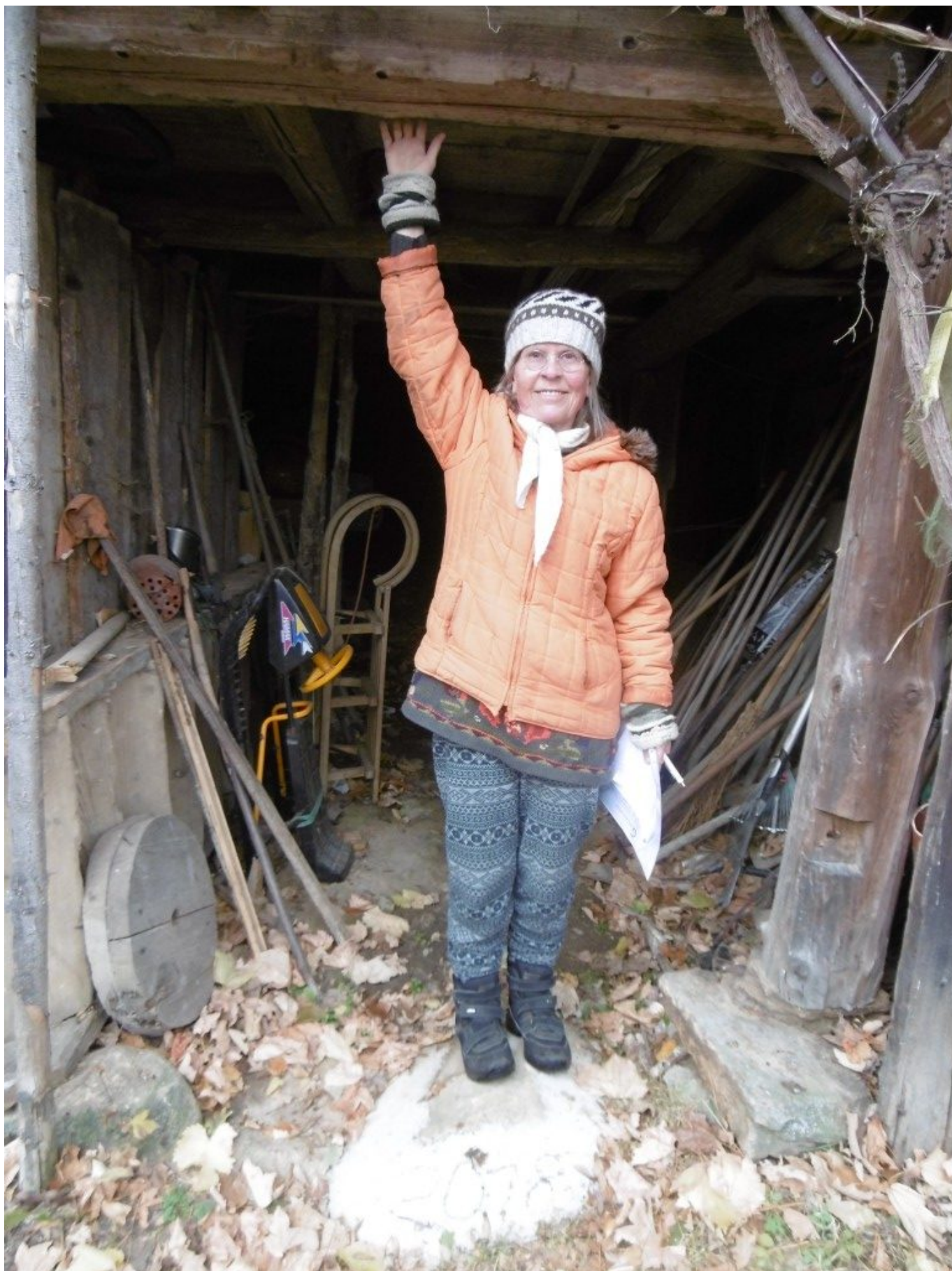
Alter baufälliger Schuppen
