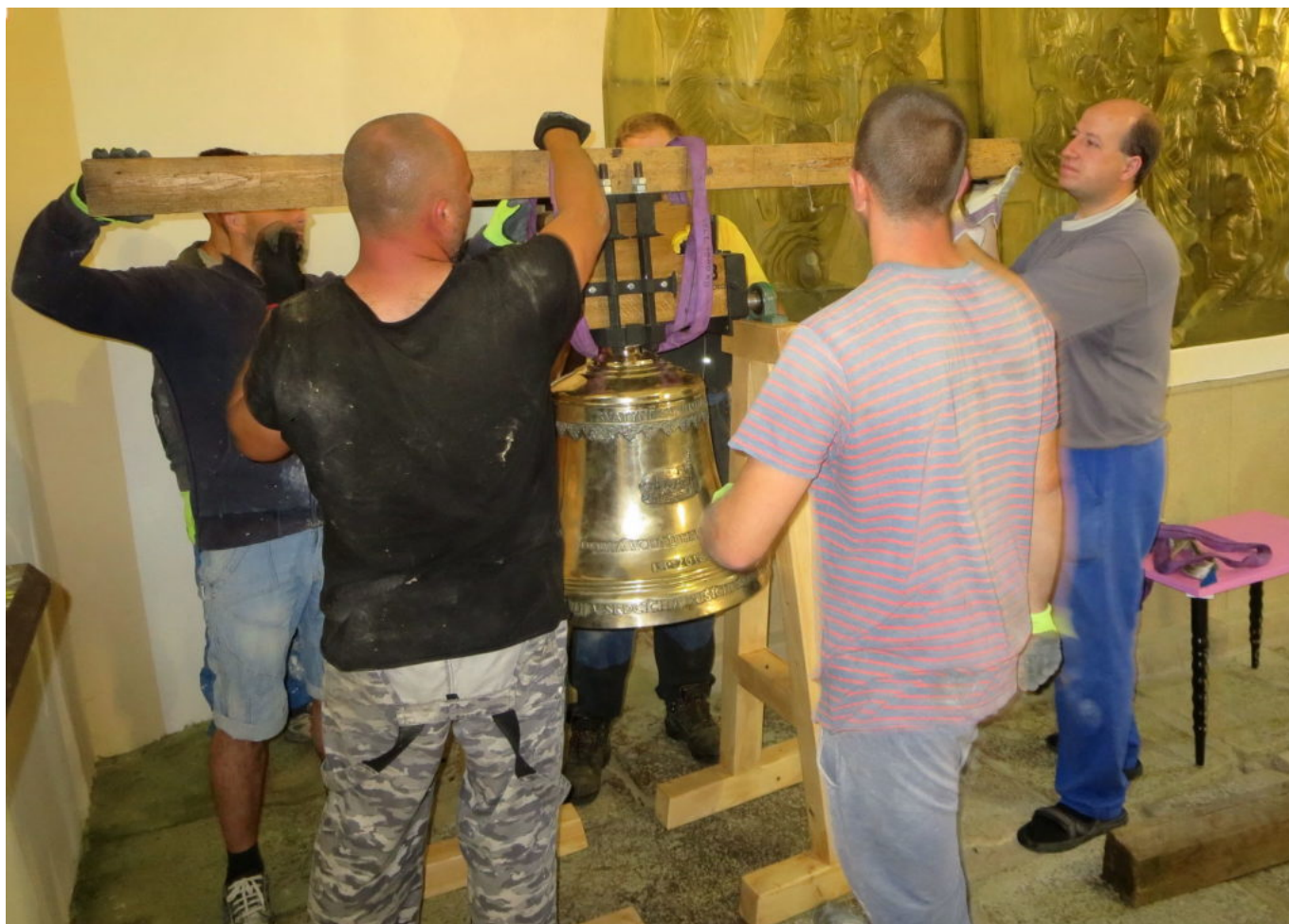
Glockeninstallation in Gutwasser
